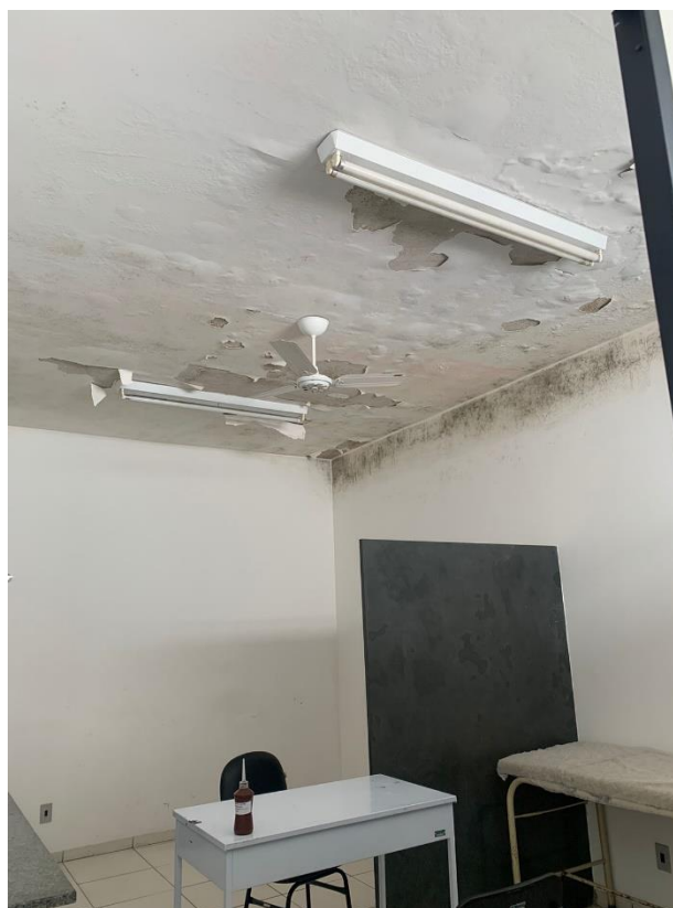
Figura 2 - Infiltrações devido ao problema do telhado Fonte: Arquivo pessoal – Cristiane Dornelas Saviotti
