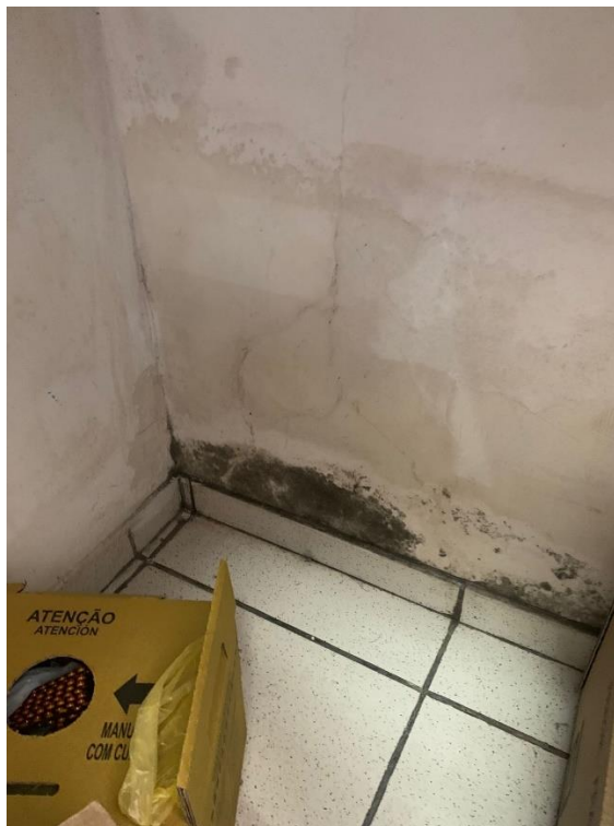
Figura 10 – Infiltrações nas paredes internas Fonte: Arquivo pessoal – Cristiane Dornelas Saviotti
